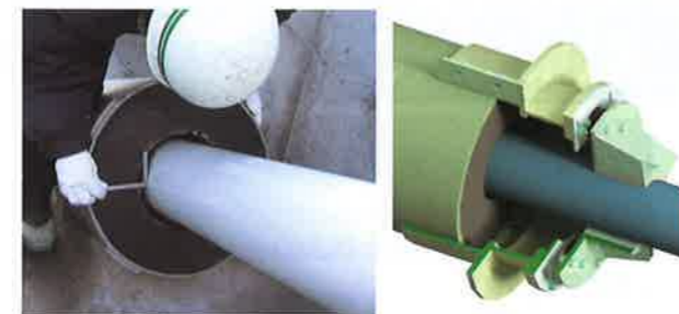
写真-3 隙間付緩衝材(矢作橋)
